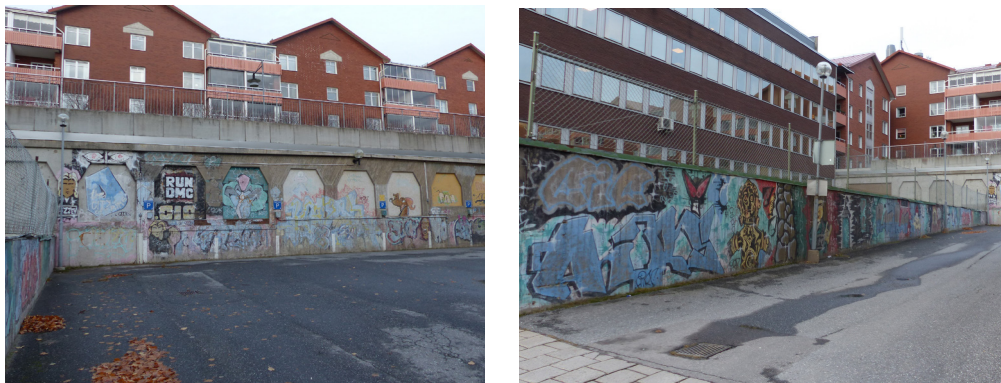
T.V: Graffiti på muren inom fastigheten 13. T.H: Graffiti på muren fastigheten Ripan 11. Foto: Tyréns AB
